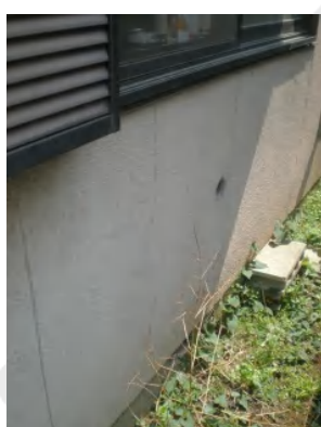
外壁に穴がありました
