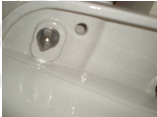
漏水例の多い箇所ですが問題ありませんでした
