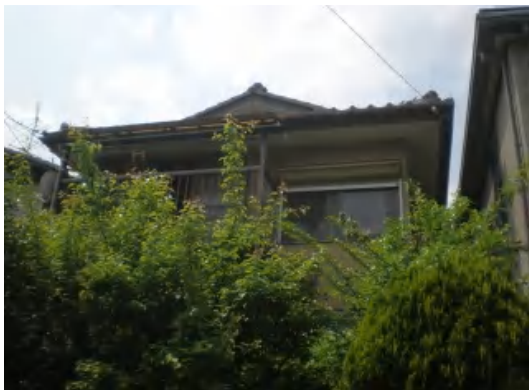
庭木が繁茂して外壁等確認し難い状況
