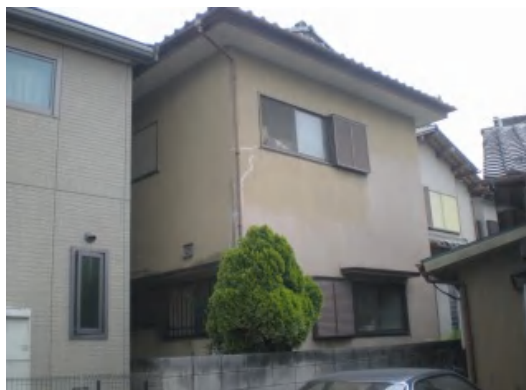
外壁クラックが顕著でした
