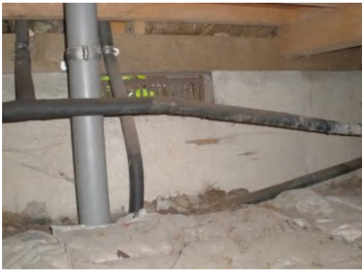
写真 18 台所給水給湯排水管
