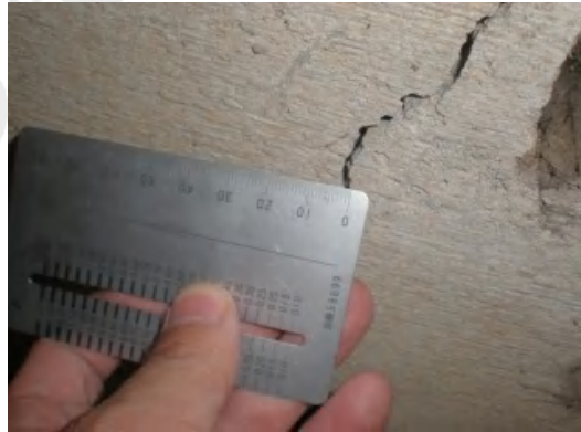
写真 21 基礎クラック
